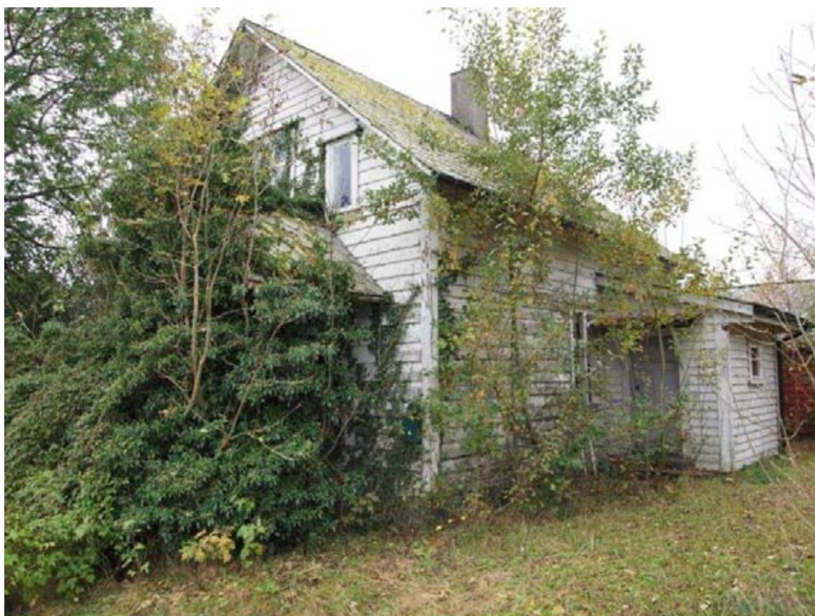
SEFRAK-registrert bygg 1: Hovudhuset er gamalt, men har ikkje vore i bruk på mange år og er falleferdig.
