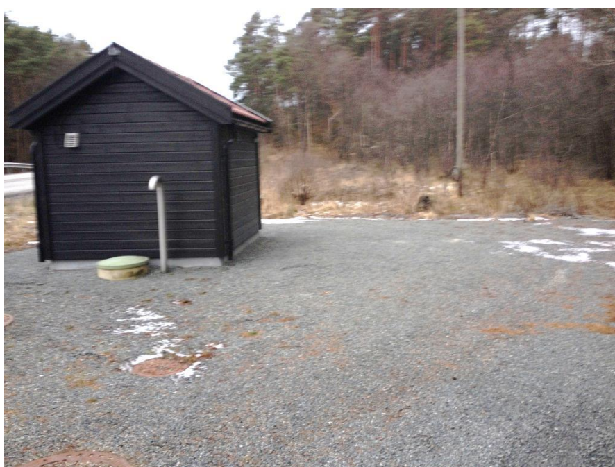
Figur 10 Justagjerdet avløpspumpe­stasjon er ein tradisjonell pumpe­stasjon
