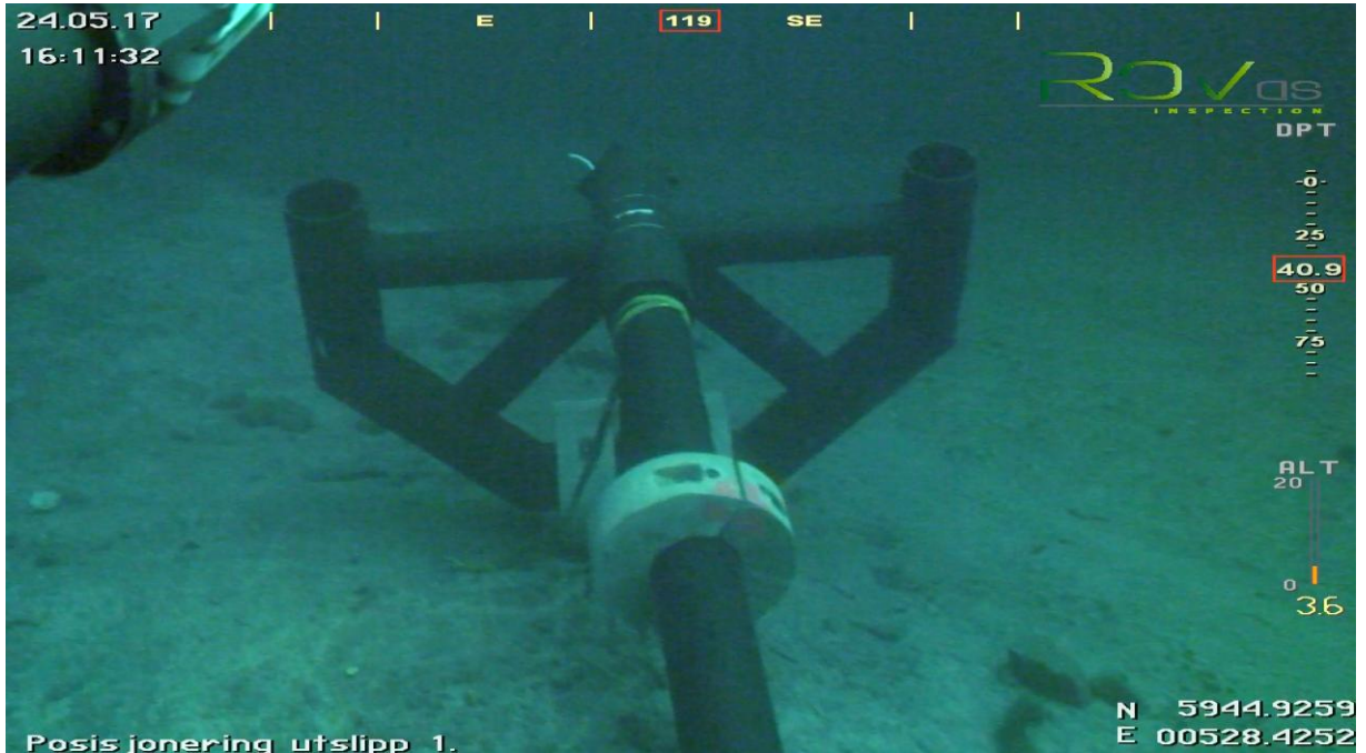
Figur 8: Utsleppsledning ved Skjersholmane. Ledningen har betonglodd for ikkje å flyte opp samstundes som det er montert eit "endehjul" for å halde ledningen oppe frå sjøbotn.
