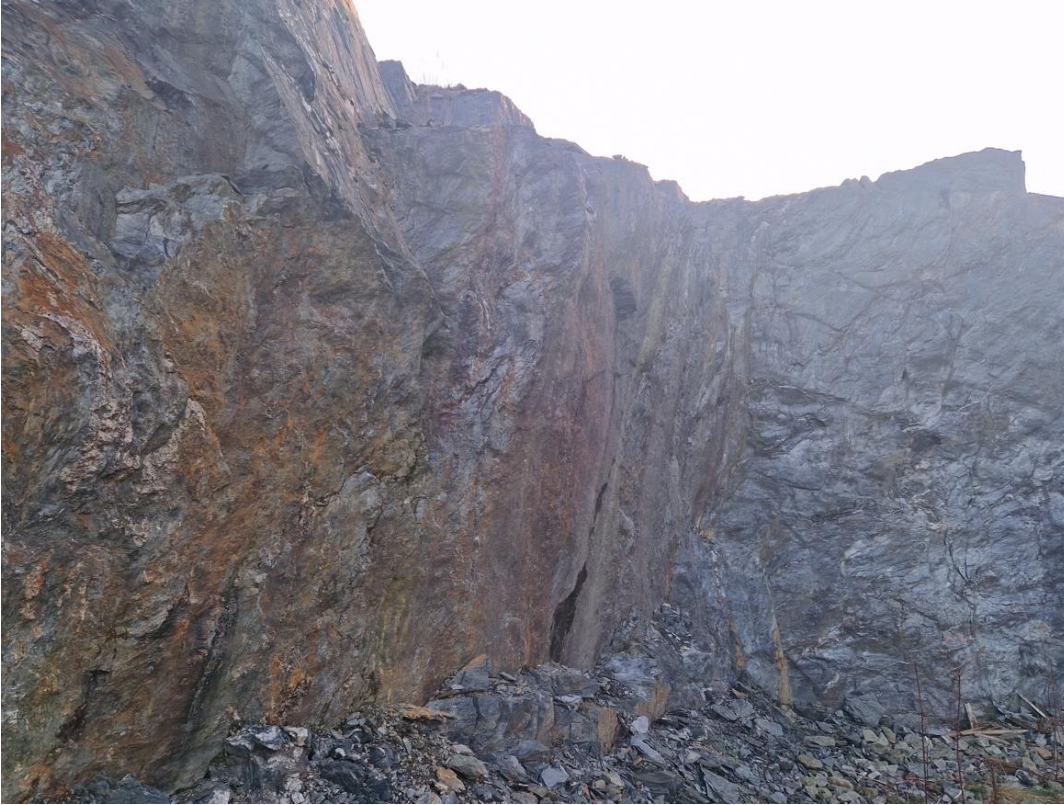
Figur 6: Steilstående (85°) foliasjon i fyllitten og tynnplattig nedfall i foten. Tydelig rustfarget jernoksid i deler – blikk mot sør.
