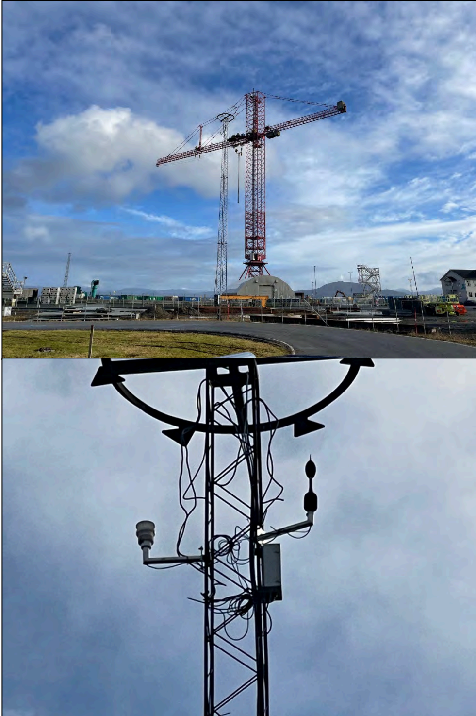
Figur 1-2: Bilde av mast er vist øverst og bilde av målestasjon 1, som er montert på mast, er vist nederst. Det er også montert en værstasjon som henter inn meteorologiske data, som vindstyrke og vindretning. Bildene er tatt av Norsonic AS, datert 17.02.2022.
